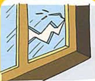
11- Verre cassé pas remplacé, remplacé par un carton.
